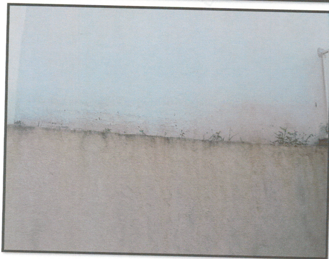
Figura 5- Umidade na alvenaria, causada pelos jardins externos da câmara
