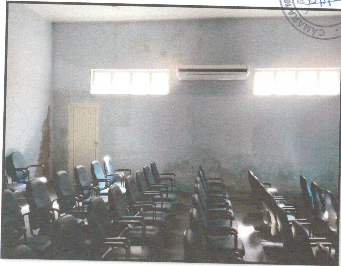
Figura 6- Patologias causadas pela umidade proveniente do transbordo da calha do telhado
